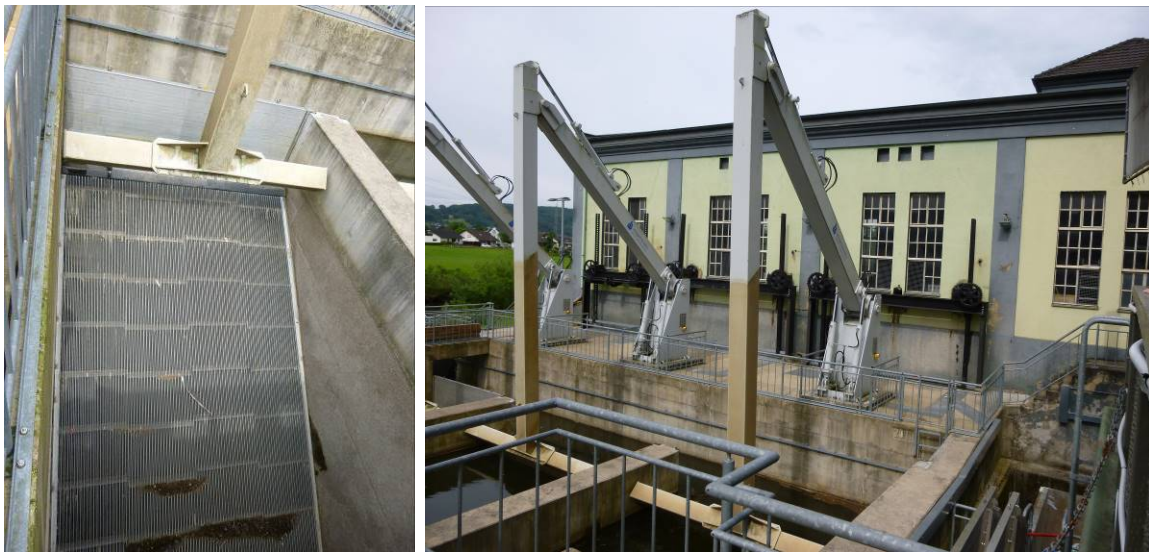
Abbildung 9. Vertikalrechen (10 mm) der Fischabstiegsanlage am Wasserkraftwerk Unkelmühle.
